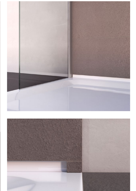
Ein kleines Fliesenstück wird hinter der Duschatrennung aufgesetzt, um den Hohlraum zu schließen
